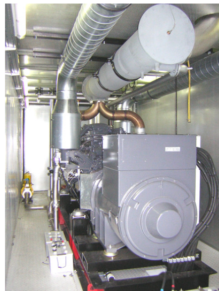
Impianto di cogenerazione alimentato ad olio vegetale, 540 kW el
