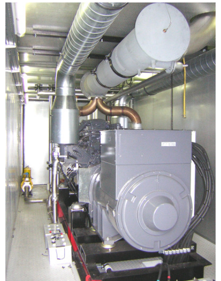
Pflanzenöl-BHKW, 540 kW el
