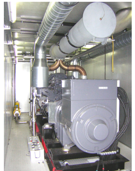
Pflanzenöl-BHKW, 540 kW el
